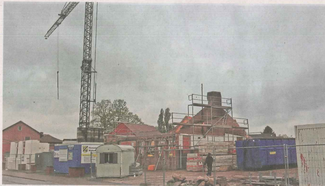
Die Bauarbeiten rund um die Alte Schmiede schreiten voran. Der Wahrenholzer Gemeinderat stellte in seiner jüngsten Sitzung zusätzliche Mittel zur Anschaffung eines Eisspeichers zur Verfügung.
